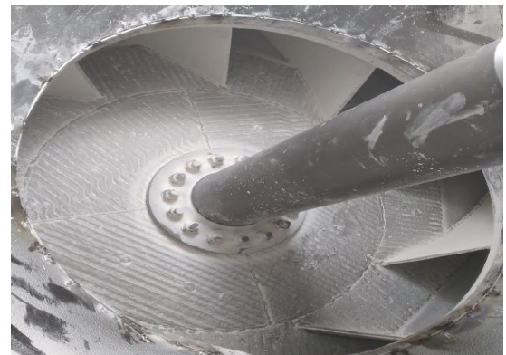
Raw Mill Fan Blade
